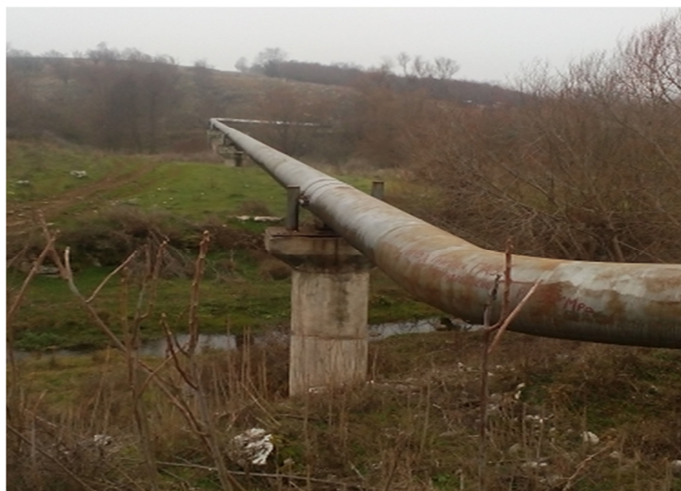
Фигура 3.8.2.1.2-7. Общ изглед в посока запад на въздушния преход над дере Осеновец (близък план) и р. Каменка (в далечина)
