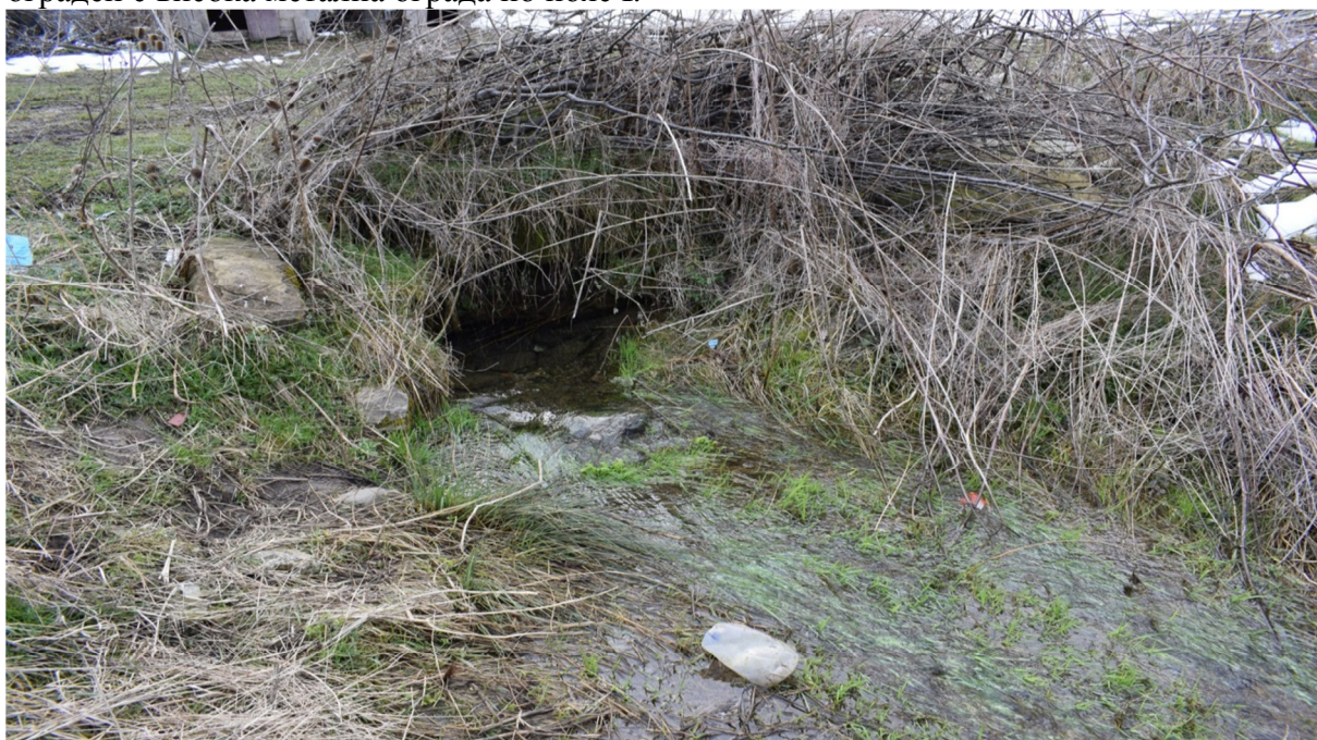
Снимка 17. Преливник на водата от резервния водоизточник каптаж „Голямата чешма“ за водоснабдяване на с. Беленци
